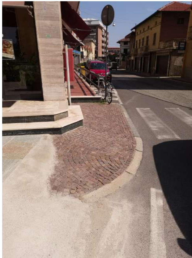
Area di raccordo tra la piattaforma, la nuova pavimentazione e la rampa pedonale
