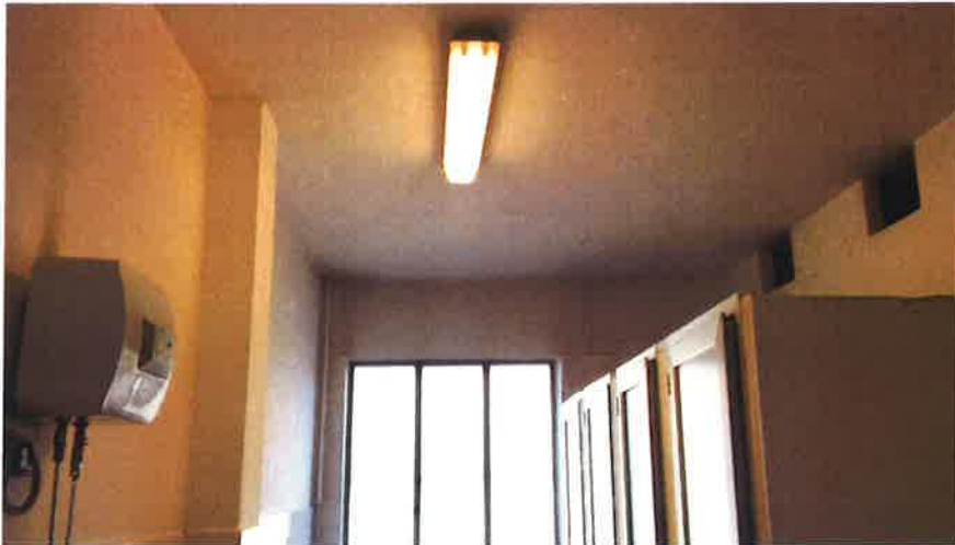
Impianto di illuminazione esistente
