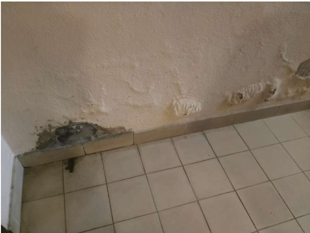
Intonaco ammalorato nel vano scale interno
