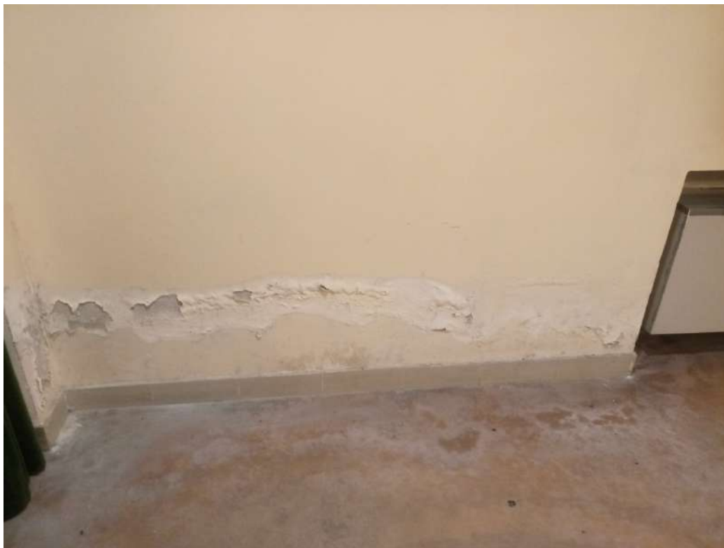
Intonaco ammalorato nella Sala conferenze
