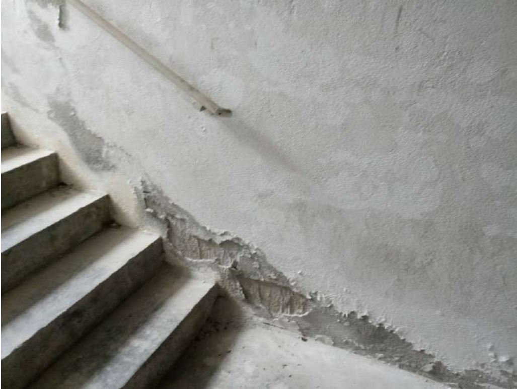
Intonaco ammalorato nel vano scale esterno
