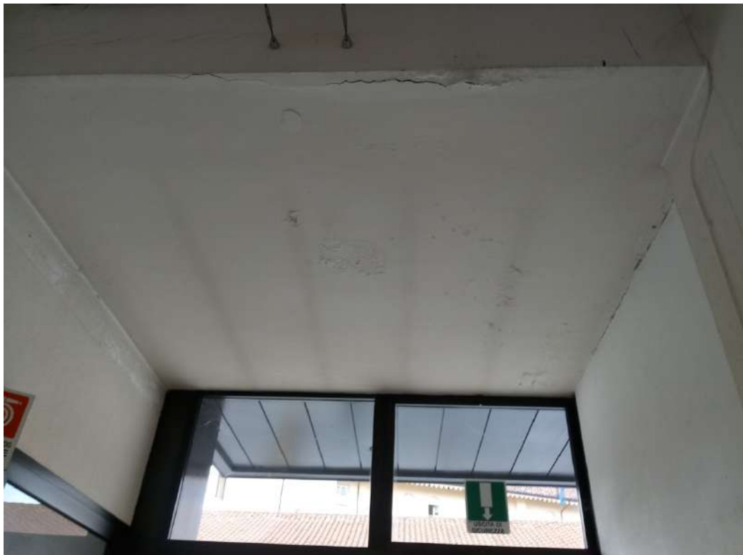
Intonaco ammalorato nel soffitto vano scale interno
